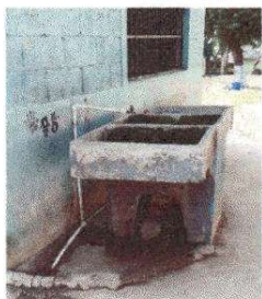
Foto 9: Pila de cocina requiere cambio, por deterioro.
