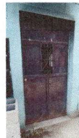
Foto 10: Puerta de cocina requiere mantenimiento y cambio de chapa.
