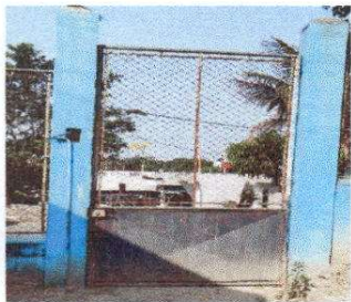
Foto 7: Porton de ingreso requiere cambio por deterioro.
