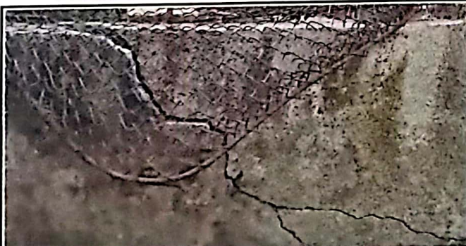
FOTO 5 MURO PERIMETRAL CON RAJADURA Y MAYAS DETERIORADAS
