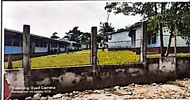
FOTO 3: LADO ORIENTE DEL MURO PERIMETRAL, DETERIORADOS
