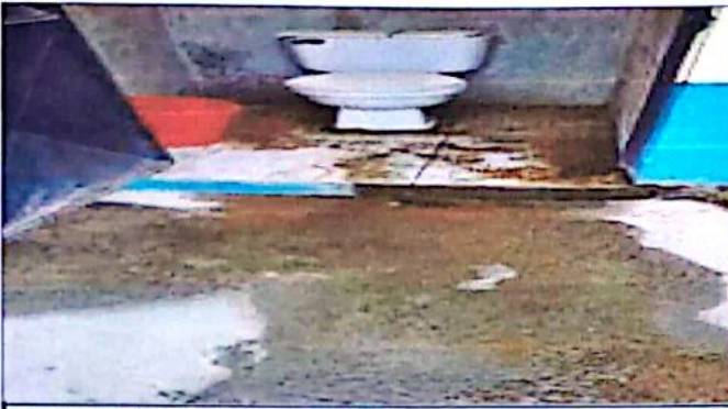
Foto 3: Servicios sanitarios y accesorios
