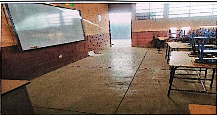
Foto 5: Aula 4, piso con torta de cemento, primero y segundo primaria. Instalación de piso cerámico y pintada del aula interna y externa.
