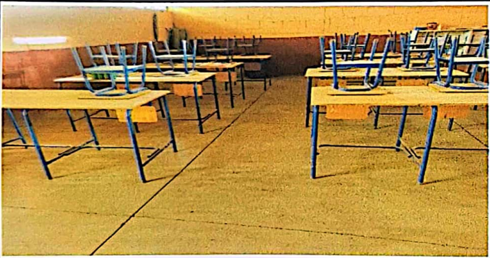
Foto 3: Aula 3, piso con torta de cemento, grado de preprimaria. Instalación de piso cerámico y pintada del aula interna y externa.
