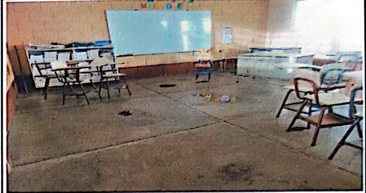
Foto 2: Aula 2, piso con torta de cemento, sexto primaria. Instalación de piso cerámico y pintada del aula interna y externa.
