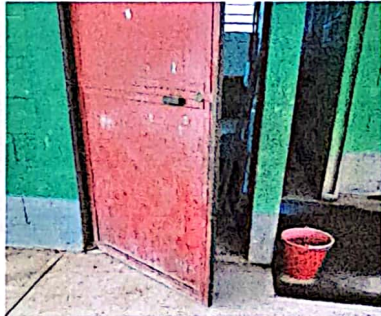
Foto 3: puerta en mal estado
