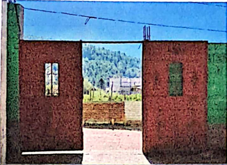
Foto 1: portón en mal estado
