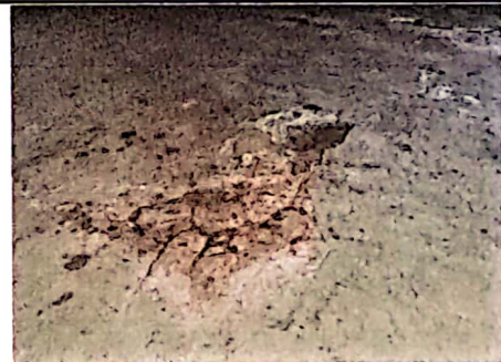
Foto 11: Suelo de cocina en mal estado
