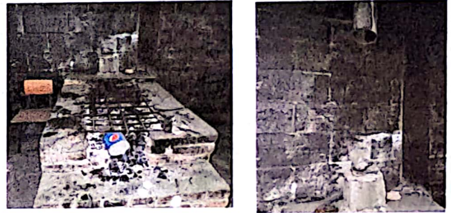
Foto 9: Estufa y chimenea en mal estado
