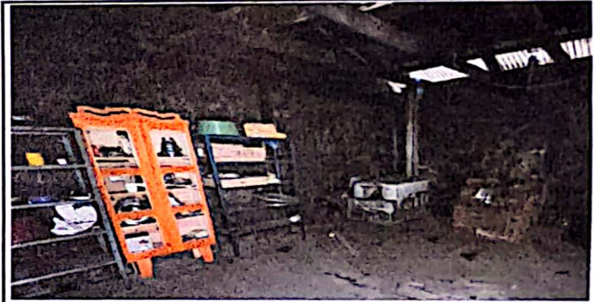
Foto 4: cocina y plancha en mal estado
