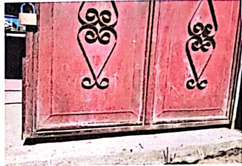
Foto 2: portón en mal estado
