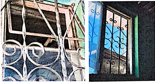
Foto 7: Ventanas en mal estado
