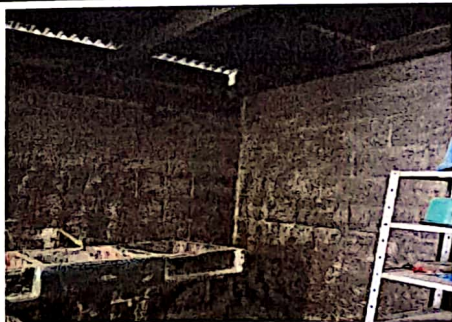
Foto 10: Pared en mal estado
