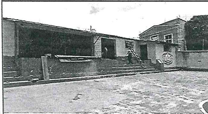
Foto 3: AULAS QUE NECESITAN PINTADA
