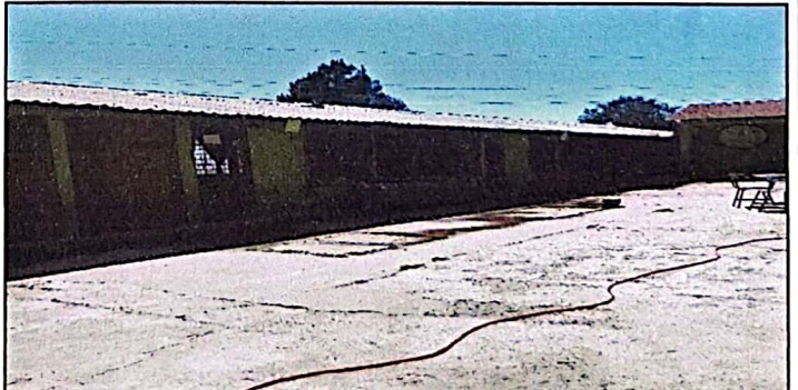
Foto 6: AULAS QUE NECESITAN PINTADA
