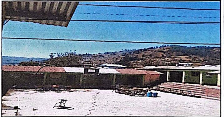
Foto 4: LAMINAS QUE NECESITAN SER CAMBIADAS
