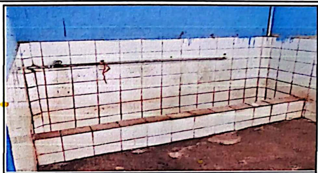
Foto 2: Baño de hombres en mal estado
