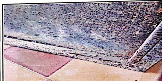
Foto 11: Puerta de dirección en mal estado
