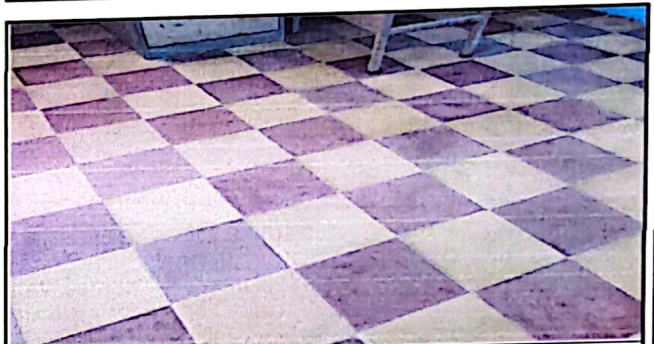
Foto 10: Piso en dirección en mal estado
