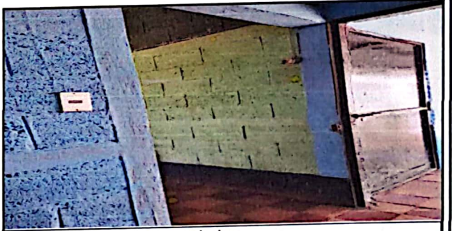
Foto 12: Falta de puerta interna a bodega
