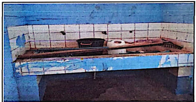
Foto 4: Lavamanos de niños y niñas en mal estado
