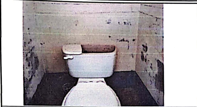
Foto 1. Tazas y accesorios en mal estado
