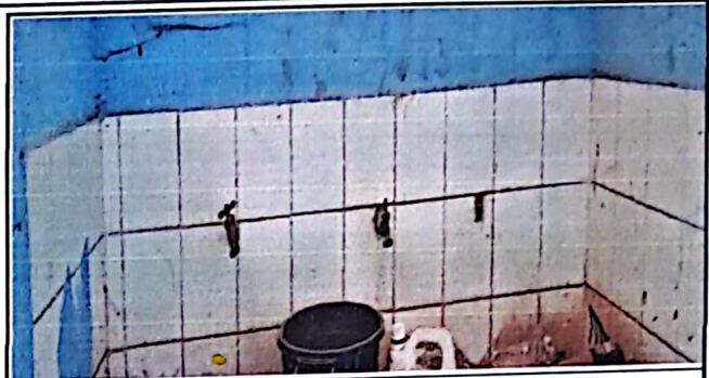
Foto 8: Chorros de lavamanos en mal estado
