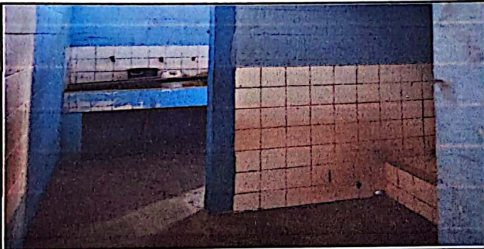
Foto 14: Azulejo en los baños en mal estado
