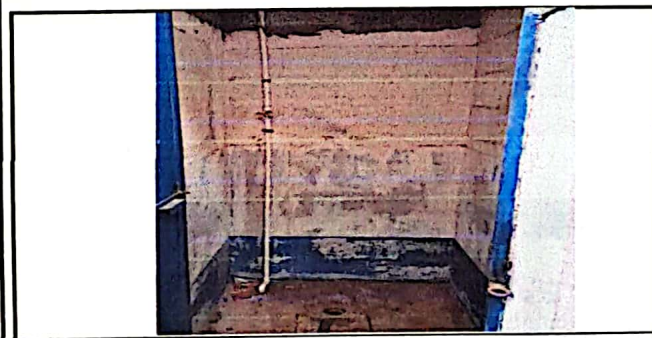
Foto 5: Paredes del baño está en mal estado
