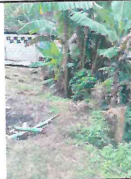
FOTO 4. Aquí es donde se necesita el muro de contención porque solo esta relleno.
