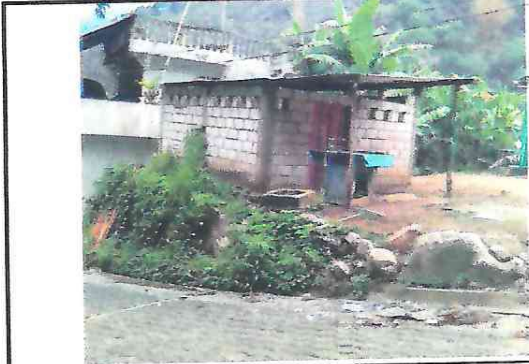
FOTO 2. La construcción de la escuela se encuentra debajo de la comunidad y la calle cuando llueve la corriente entra en el patio.
