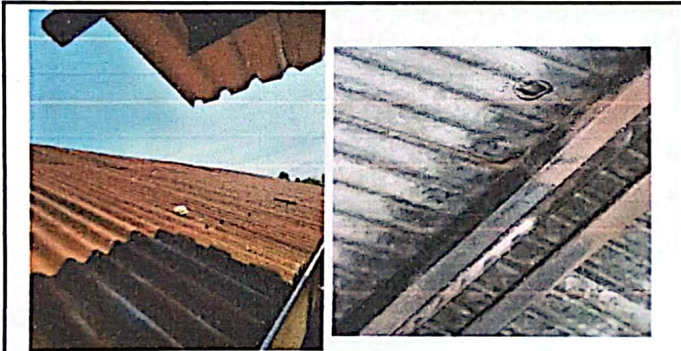
Foto 9: Deterioro de techo de lámina de dos aulas y corredor.
