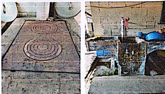
Foto 4: Deterioro de plancha de estufa de leña y de lavadero.
