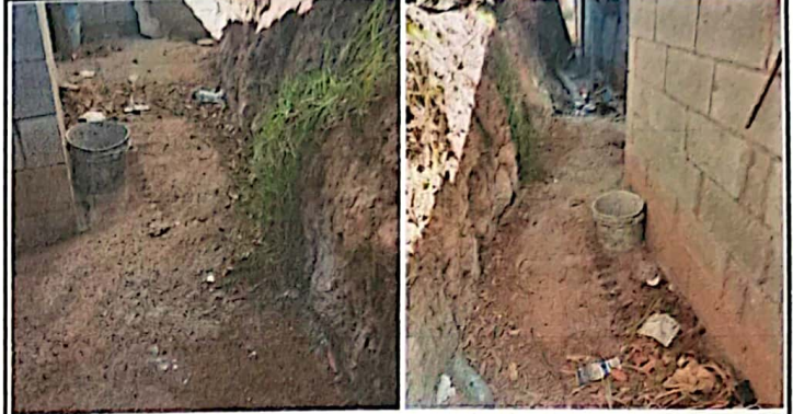
Foto 2: Torta de Cemento en los lados exteriores de las aulas.
