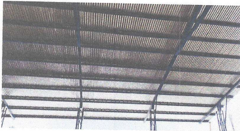
Foto 9: Cubierta de techo requiere cambio por condiciones climáticas.
