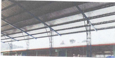
Foto 7: Cubierta de techo requiere cambio por condiciones climáticas.
