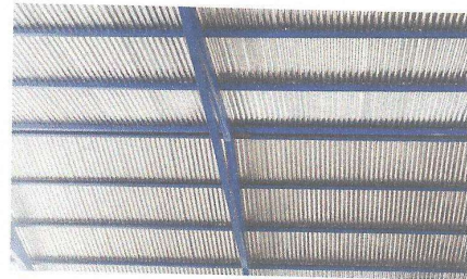
Foto 10: Cubierta de techo requiere cambio por condiciones climáticas.
