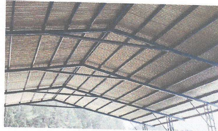
Foto 8: Cubierta de techo requiere cambio por condiciones climáticas.
