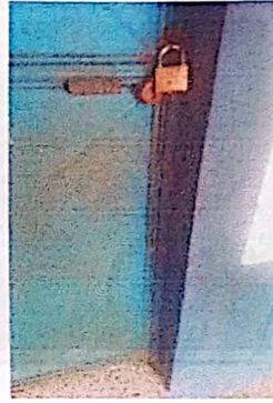
Foto No. 4. Puertas inseguras sin chapa.
