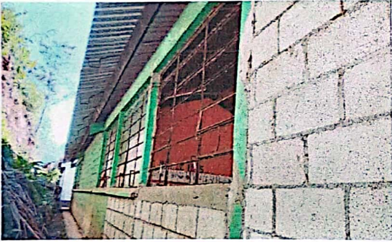
Foto No. 3. Ventanas en mal estado (balcones derrumbados).
