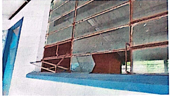
Foto No. 2. Vidrios deteriorados
