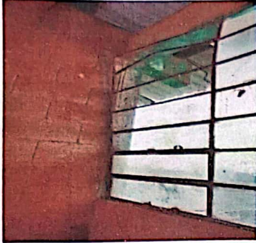
Foto No. 1. Base de ventanas en mal estado
