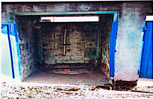
Foto 3. Falta instalación de inodoro y sus accesorios
