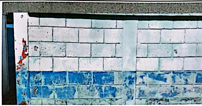
Foto 1: Los muros están en mal estado
