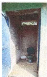
Foto 5: Servicios sanitarios 2 requieren mejoramiento en inodoros, paredes y piso.
