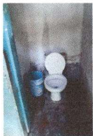
Foto 1: Servicios sanitarios 1 requieren mejoramiento en inodoros, paredes y piso.
