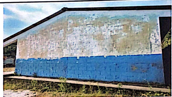
Foto 4. El edificio escolar necesita de una pintada interior y exterior para que los alumnos estén en un lugar cómodo.
