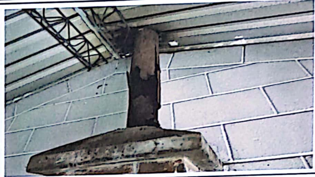
Foto 2. La chimenea por los años de uso se ha deteriorado
