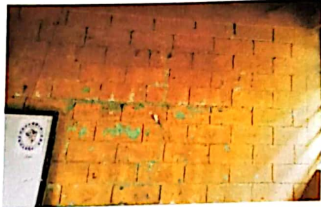
Foto 3: Pintura deteriorada en paredes de aulas a pintura nueva
