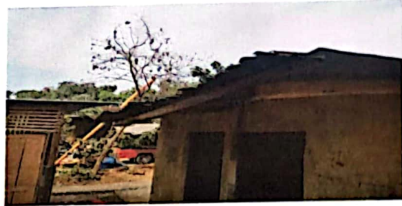
Foto 4: Cubierta de lamina y estructura de techo deteriorada del baño a laminas y costaneras nuevas.
