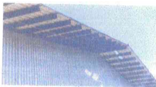
Foto 4: Las láminas deterioradas presentan roturas y fisuras
