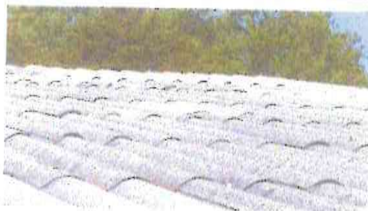
Foto 3: Las láminas fibrocemento están parchadas por deterioro y necesita sustituir.
