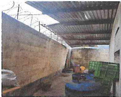
Foto 3: techo de cocina en mal estado, colocación de machimbre.
