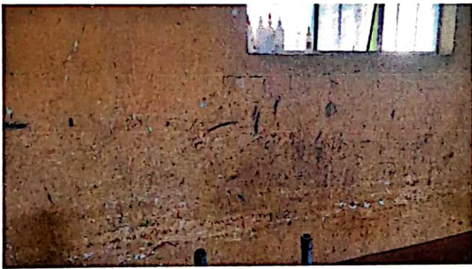
Foto 3: Pared manchada en mal estado, necesario pintarlas.
