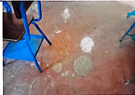
Foto 6: Piso en mal estado.
