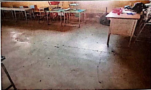
Foto 5: Piso en mal estado
