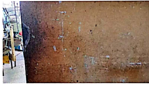
Foto 4: Pared manchada en mal estado, necesario pintarlas.
