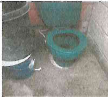
Foto 5: Sustrucción de baños en mal estado
