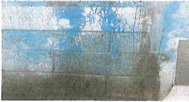
Foto 1: Sustrucción de paredes por filtro de agua
