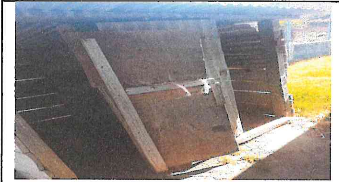
Foto 1: Baños en mal estado
