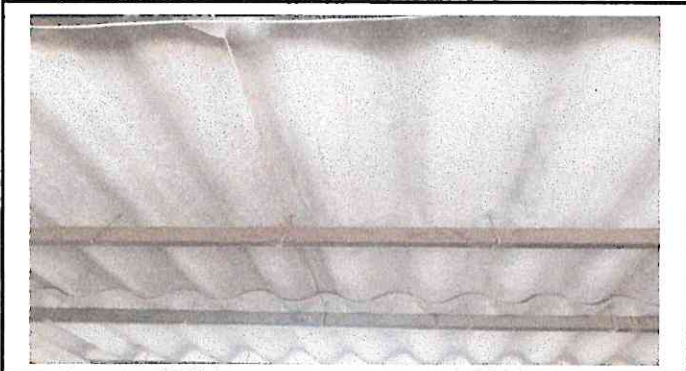
Foto 3: Techo de duralita en mal estado y gotea
