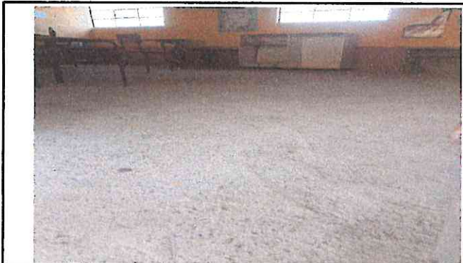
Foto 4: Piso de cemento en mal estado
