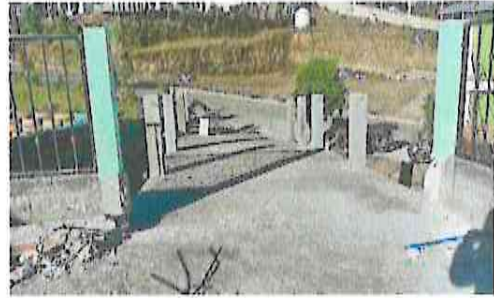
Foto 2: sustitución de piso estructural a a piso de concreto con un avance del 80%
