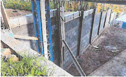
FOTO 1: MURO DE CONTENCIÓN: Área donde se filtra corriente de agua que afecta las aulas.
