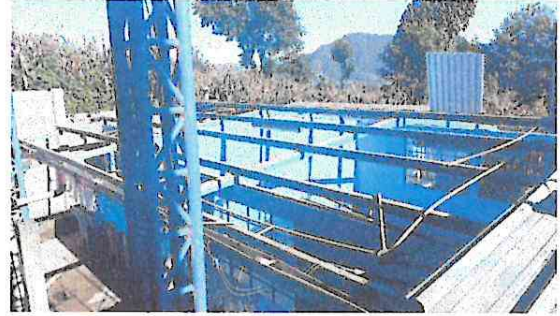
FOTO 2: CUBIERTA DE LÁMINA. Por deterioro, óxido, perforación de techo la cual se filtra agua dentro del aula y cocina.
