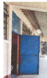
Foto 8: Puertas de modulo de aulas requieren mantenimiento.
