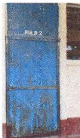
Foto 7: Puertas de modulo de aulas requieren mantenimiento.
