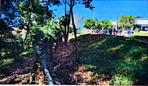
Foto 1: Muro de contención en mal estado, la lluvia botó la mayor parte
