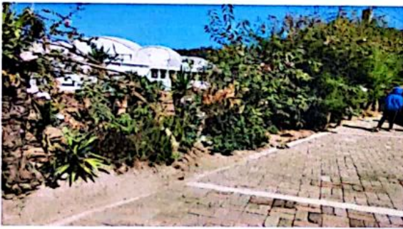
Foto 3: Por los años que lleva la malla del muro perimetral se oxido y calló
