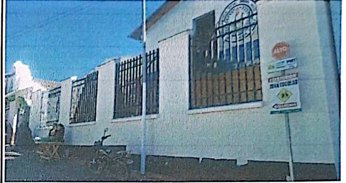
Foto2: Nos damos cuenta del peligro que presente el cerco cada vez sus bases estan debilitando y se mueven por cualquier movimiento por lo tanto es un gran riesgo para cualquier persona que pasa a su alrededor
