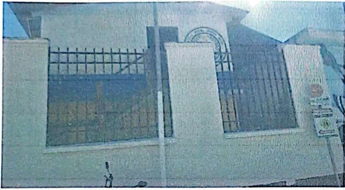
Foto1: En la presente imagen observamos que este cerco esta en malas condiciones ya que carece de columnas y soleras.
