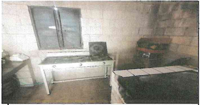
FOTO No 2: ÁREA DE COCINA EN MAL ESTADO
