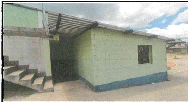
FOTO No 5: LAS GRADAS DEL BAÑO NECESITAN BARANDAS PARA EVITAR ACCIDENTE.
