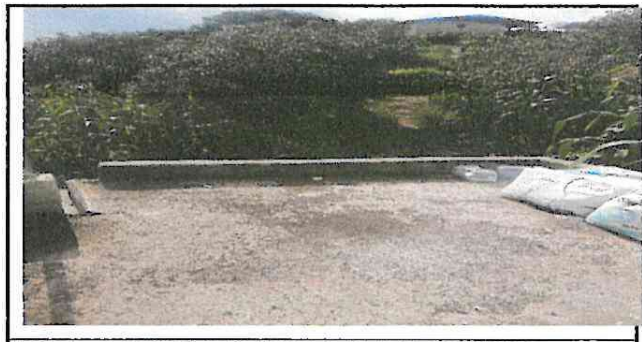
FOTO No. 6: SOBRE LOS BAÑOS NECESITA CERCO O MURO PERIMETRAL PARA EVITAR ACCIDENTE.
