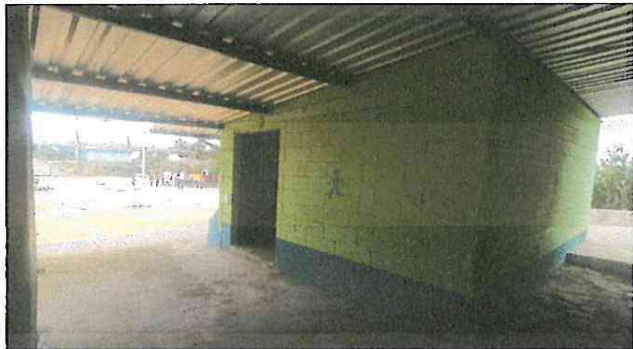
FOTO No 1. COCINA, ESTRUCTURA DE TECHO EN MUY MAL ESTADO
