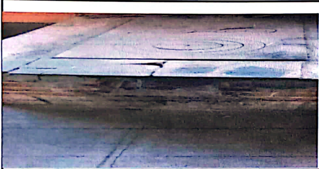
Foto7: PLANCHA EN MAL ESTADO
