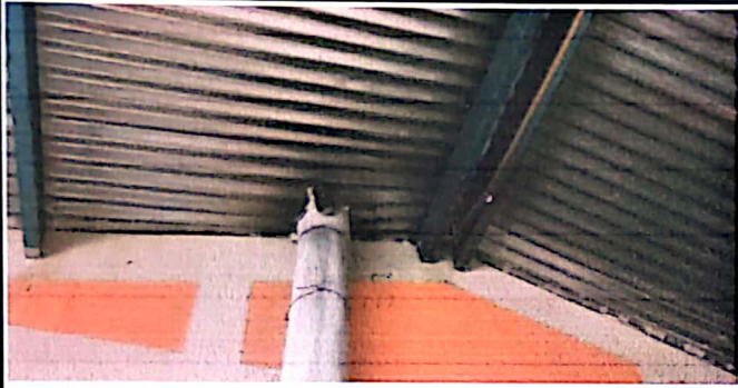
Foto 1: LAMINA DE LA COCINA EN MAL ESTADO
