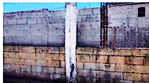
Foto 4: pintura de paredes y aulas en mal estado
