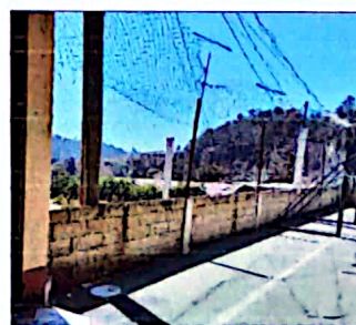
Foto 6: La circulacion de la cancha necesita barrandas
