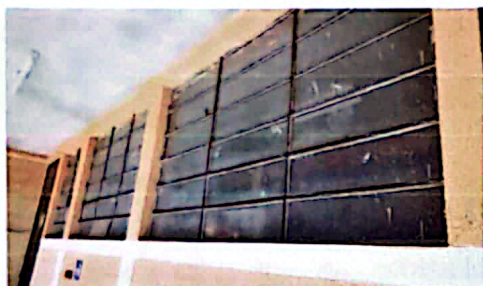
Foto 1: las ventanas de aulas necesita balcones
