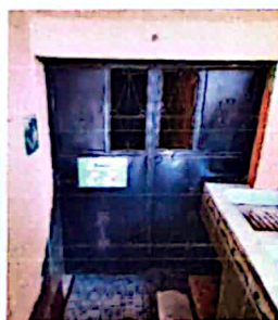
Foto 3: La puerta del Baño en mal estado
