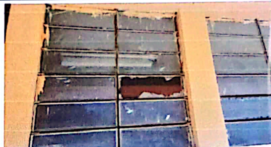
Foto 2: vidrios quebrados de varias ventanas
