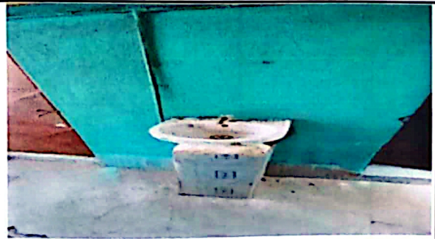
Foto 6: Lavamanos en mal estado
