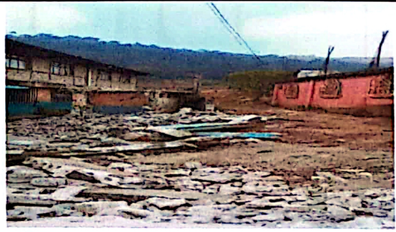
Foto 4: Baños esta en mal estado
