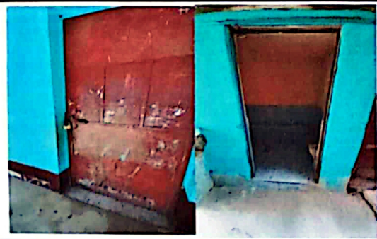
Foto 5: Puertas y chiapas en mal estado
