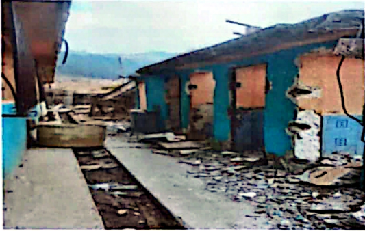
Foto 1: Baños en mal estado
