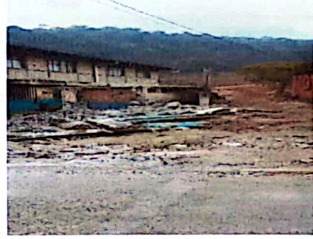
Foto 2: Baños del Instituto están en malas condiciones
