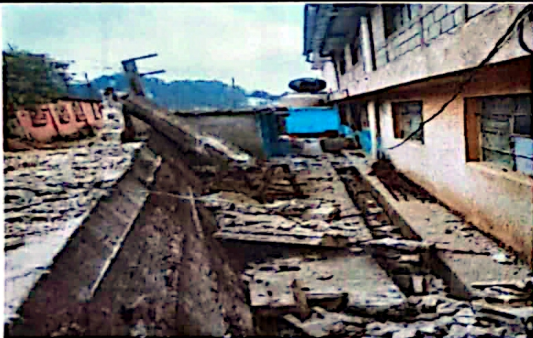
Foto 3: El Instituto no cuenta con baños porque esta en mal estado
