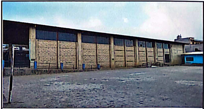
FOTO 6: HACE FALTA REFLECTORES AL CENTRO EDUCATIVO
