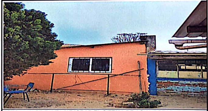
FOTO 4: HACE FALTA MEJORAR EL SISTEMA DE AGUA POTABLE Y LA BASE PARA SUMINISTRAR LA COCINA DEL CENTRO EDUCATIVO
