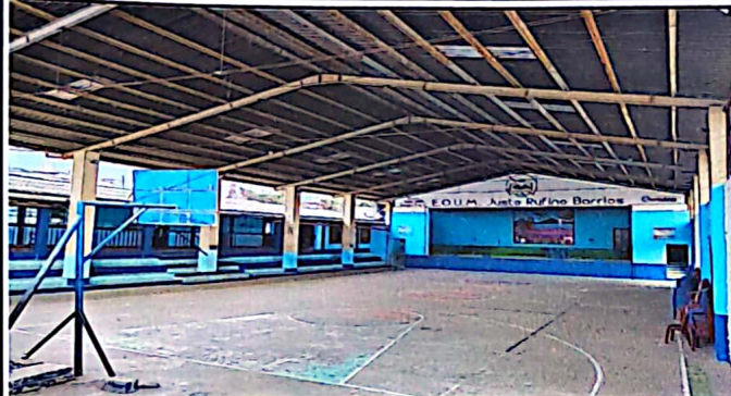
FOTO 1: SISTEMA ELECTRICO Y ALUMBRADO DE CANCHA Y ESCENARIO EN MALAS CONDICIONES
