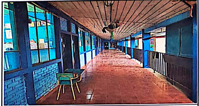
FOTO 2: SISTEMA ELECTRICO Y ALUMBRADO EN MALAS CONDICIONES
