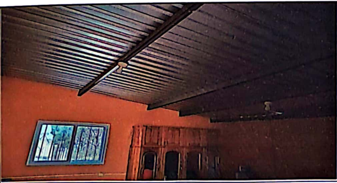
FOTO 5: AREA DE COCINA CON SISTEMA ELECTRICO DEFICIENTE Y BODEGA
