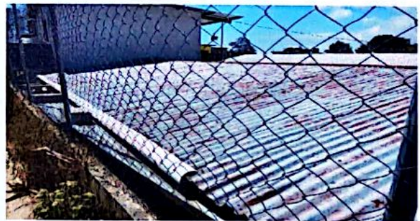
Foto 6: Techo de centro educativo en malas condiciones
