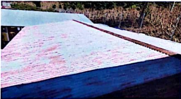
Foto 3: Techo de centro educativo en malas condiciones
