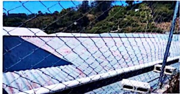
Foto 2: Techo de centro educativo en malas condiciones
