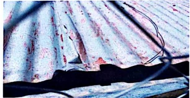
Foto 4: Techo de centro educativo en malas condiciones
