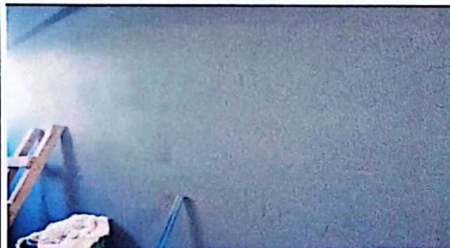
Foto 9: Pared del baño de Señorita a remodelar
