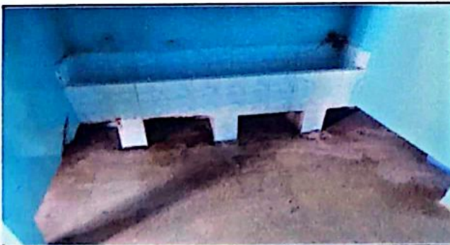
Foto 5: Mingitorio que se va a remodelar
