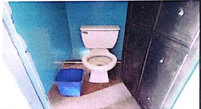
Foto 4: Servicios sanitarios de varones que se va a cambiar todos los sanitarios.
