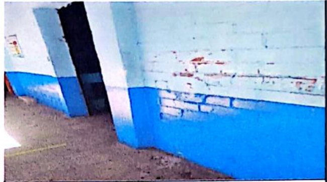
Foto 2: Parte de los servicios de damas para remodelar
