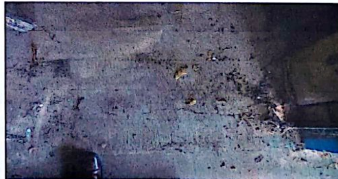
Foto 6: en la fotografía se observa el deterioro del piso del aula donde funciona el taller de cocina, por consiguiente necesita su mantenimiento.
