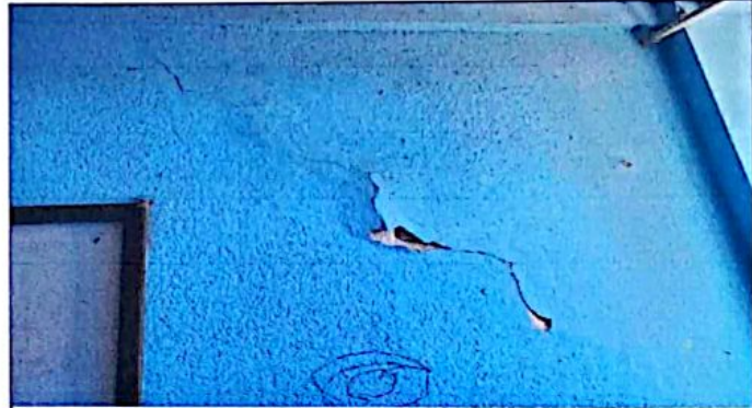
Foto 4: la caída del acabado de esta pared, necesita su reparación y por consiguiente necesita pintado.
