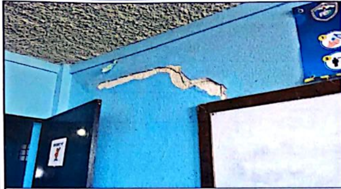
Foto 1: se puede apreciar en la fotografía el deterioro que sufre la pared en la parte interior de una de las aulas del edificio escolar.
