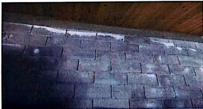
Foto 5. en el interior del aula se necesita la repación y mantenimiento de la pared, se observa el deterioro de la misma.
