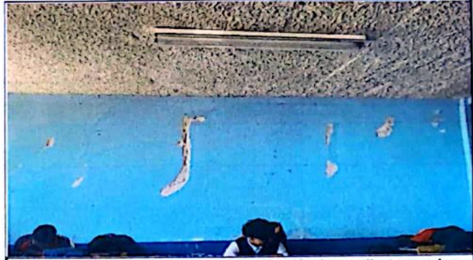
Foto 2: en esta fotografía se observa la ubicación de estudiantes en el aula, y se aprecia las grietas que tiene la pared, se estima que ante un fenómeno natural podrían caerse los pedaso de repello.
