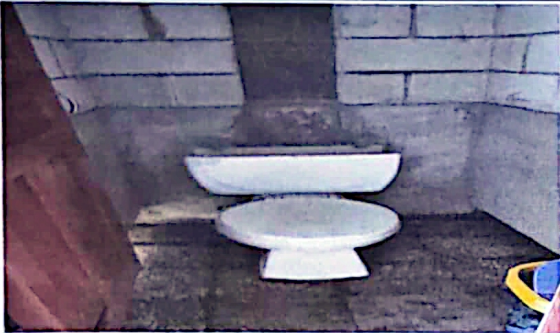
FOTO 1. SANITARIO EN MAL ESTADO.
