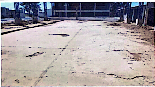
Foto 3: CANCHA EN MAL ESTADO
