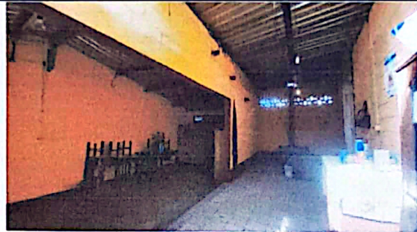
Foto 2: COCINA EN PESIMAS CONDICIONES
