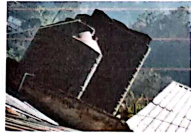
Foto 4: Rotoplast en mal estado con fuga de agua.
