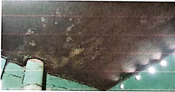
Foto 1: Techo de la cocina con filtración de agua
