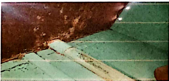
Foto 5: Tubo de chimenea en mal estado con grietas.
