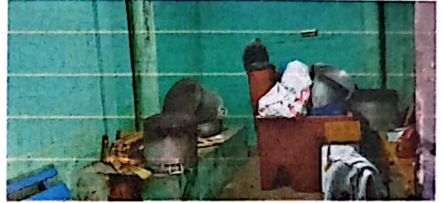
Foto 2: Cocina en mal estado, falta de conexión de pila.
