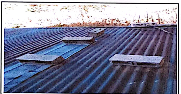
Foto 4: laminas sostenidas con bloks por deterioro del tiempo y tener demasiado oxidado para poder reparar.
