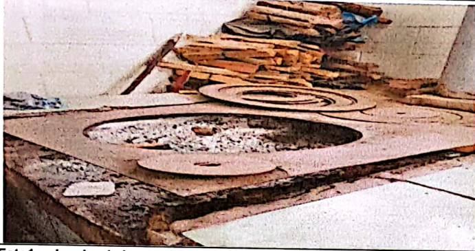
Foto 1: plancha de la cocina en mal estado por el tiempo de uso.
