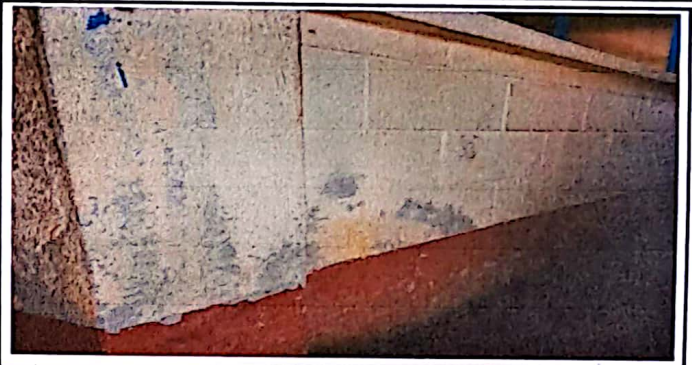
Foto 2: pintura de las paredes de la escuela en mal estado por el paso del tiempo
