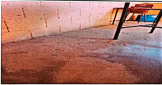
Foto 3: torta de cemento deteriorado por el tiempo de uso
