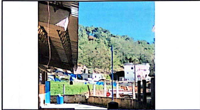
TECHO DE LA EORM EN MAL ESTADO
