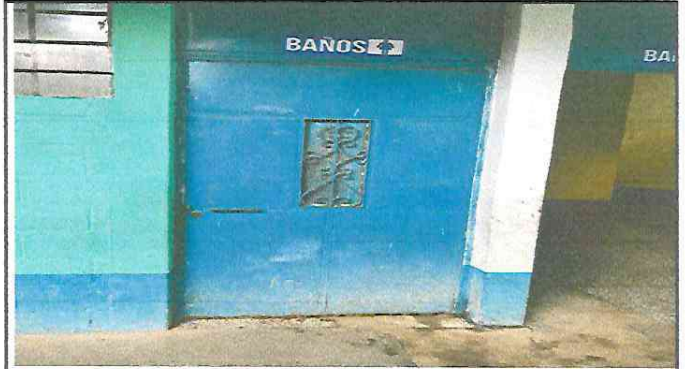
Foto 2: Puerta necesita reparación
