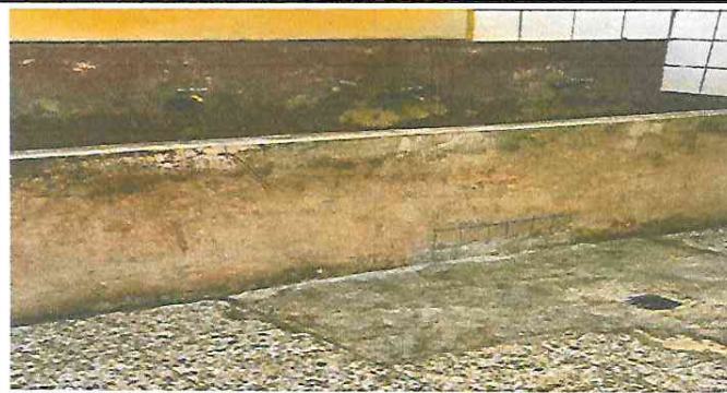
Foto 1: Lavamanos y pisos en mal estado
