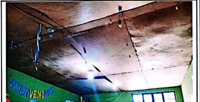
Foto 4: Techo con cielo falso en malas condiciones
