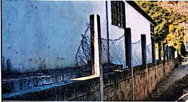
Foto 7: Maya del muro perimetral en mal estado.
