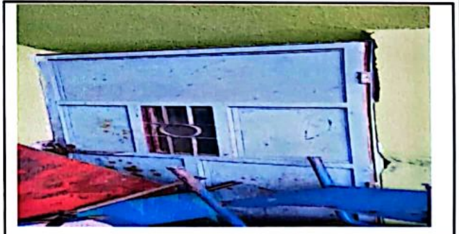
Foto 6: Puerta en mal estado
