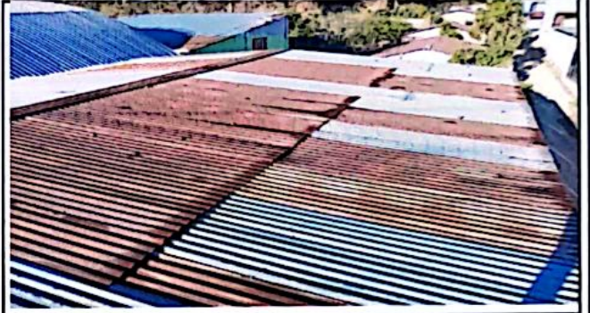
Foto 2: Cubierta de lamina de la escuela en mal estado
