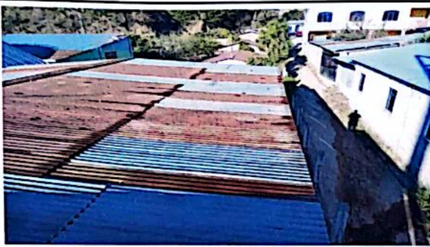
Foto 1: Cubierta de lamina de la escuela en mal estado
