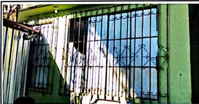
Foto 5: Ventana y balcones en mal estado
