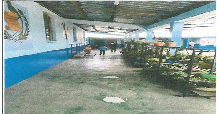
Foto 2: Corredor en mal estado, es necesario un nuevo piso
