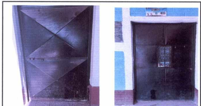
Foto 2: Repintada de puertas de Metal de los salones y ambientes del edificio escolar
