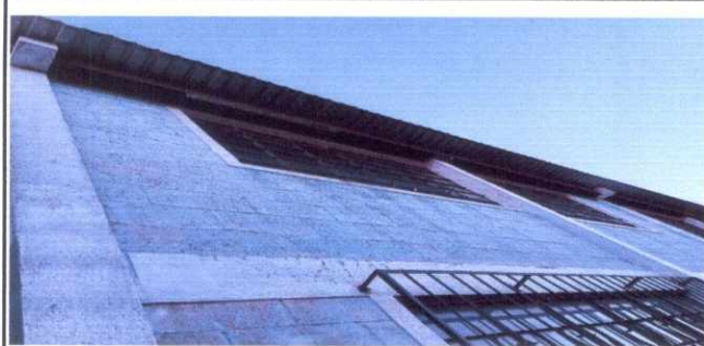
Foto 3: Falta de Canales y bajada de agua pluvial
