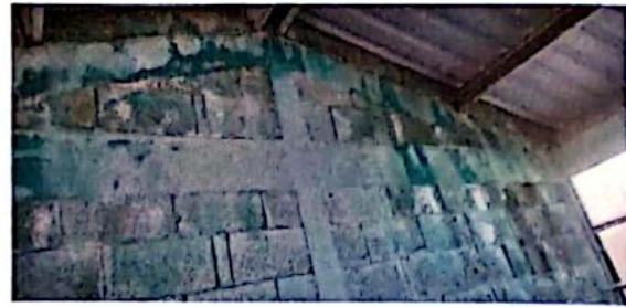
Foto 4: Así están las paredes de las aulas de la escuela, todo despintado.
