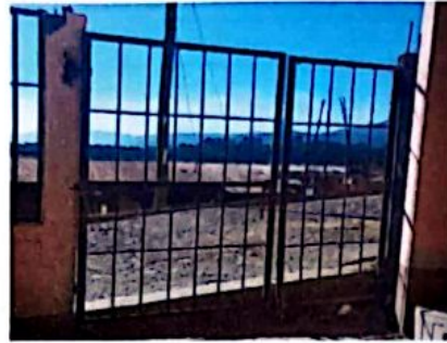
Foto 2: Los portones de la entrada principal, se encuentra deteriorado e incompleto.
