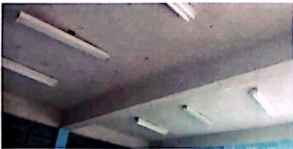
Foto 5: Las lámparas y focos están deterioradas y quemadas en todas las aulas
