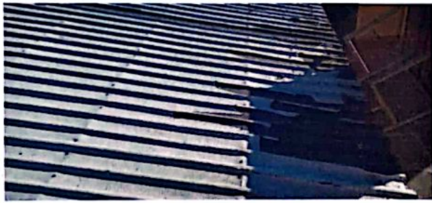
Foto 1: Las láminas de las aulas de este edificio están en muy mal estado: oxidado, y doblados y está goteando.
