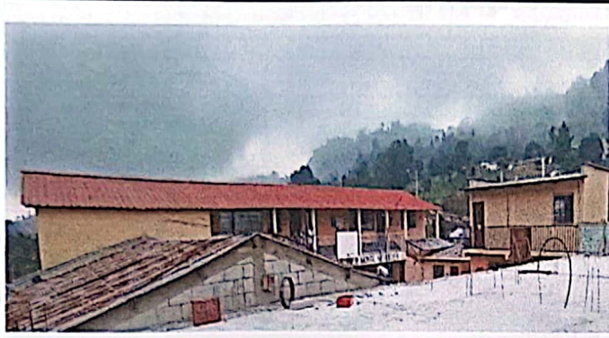
Foto 1: Sistema de captación de agua pluvial en el techo.
