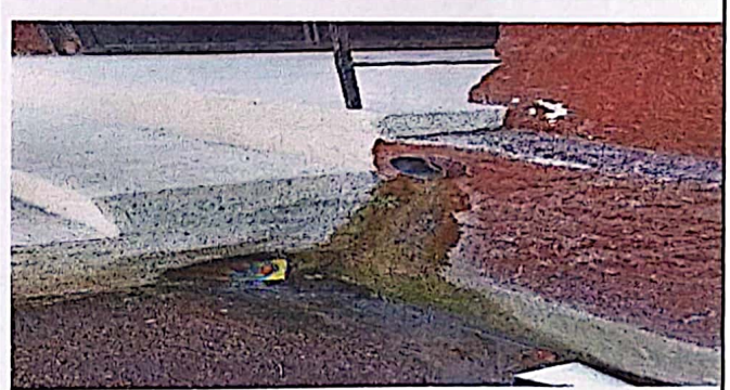
Foto 4: Sistema de captación y evacuación de agua pluvial.
