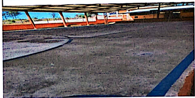
Foto 2. se encuentra con pedazos quebrados
