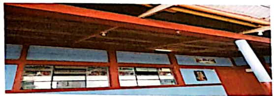
FOTO 6: TECHADO EN MAL ESTADO
