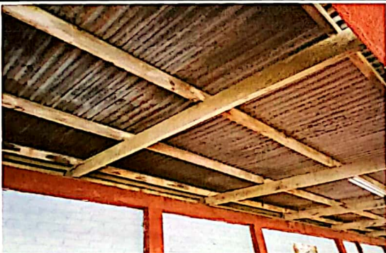
FOTO 5: TECHADO EN MAL ESTADO
