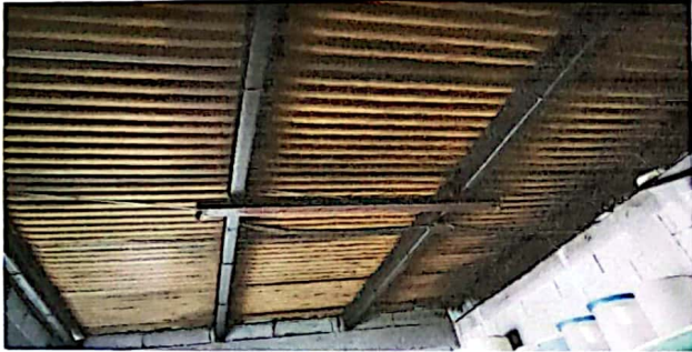
FOTO 1: LAMINA DE LA COCINA QUE SE ENCUENTRA EN MAL ESTADO
