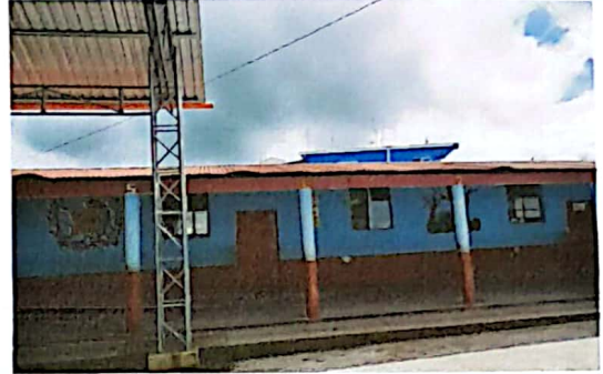
FOTO 2: LAMINAS DEL ALA NORTE EN MAL ESTADO
