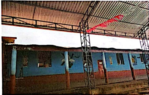
FOTO 3: LAMINAS EN MAL ESTADO
