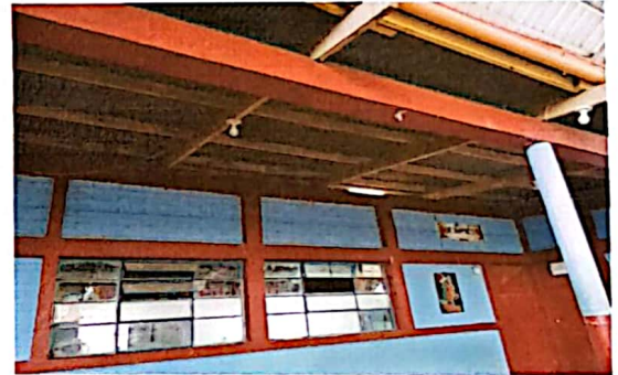
FOTO 4: TECHADO EN MAL ESTADO
