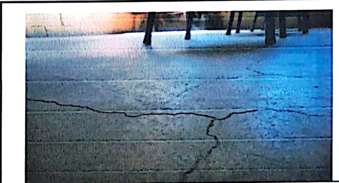
Foto 2: La torta de cemento deteriorado y ya no es apto para el ambiente de los estudiantes.
