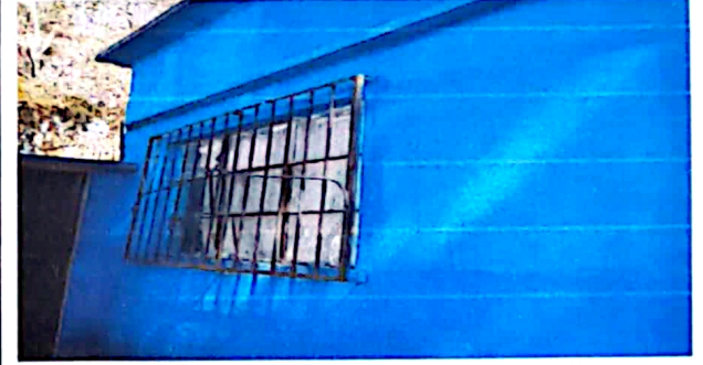
Foto 2: Balcones y ventanas que necesita mantenimiento
