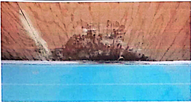
Foto 1: Techo de la cocina en mal estado, que necesita ser sustituido para evitar infecciones en la preparación de alimentación
