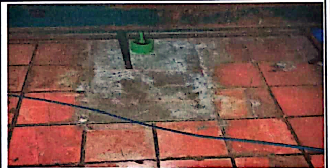
Foto 4: Pisos y azulejos de la cocina que necesita ser mejorado
