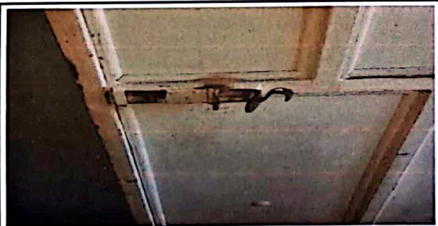
Foto 5: Puerta de la cocina que se encuentra en mal estado
