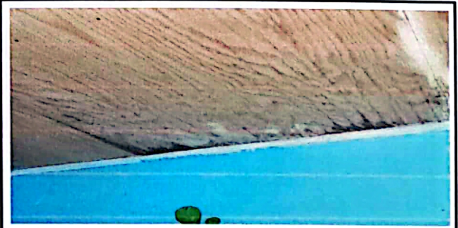
Foto 6: Techo de la cocina que están en malas condiciones
