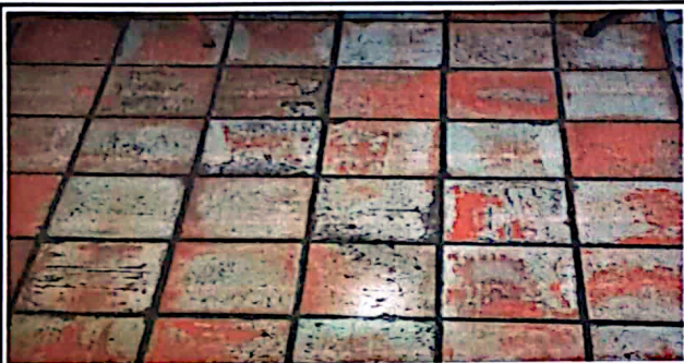
Foto 3: Piso y azulejos que necesita ser sustituido y mejorado
